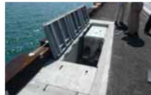
岸壁に設置された電源ケーブル接続箱
