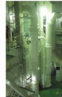
バラスト水処理のための配管
