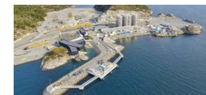
Northern Lights社のCO 2 受入基地 (ノルウェーØygarden, 建設中。提供：Northern Lights JV DA)
