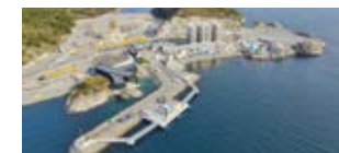
Northern Lights社のCO 2 受入基地 (ノルウェーØygarden, 建設中。提供：Northern Lights JV DA)
